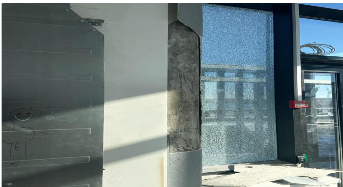
Рисунок 1 - Отслоение огнезащитного покрытия от металлической колонны
