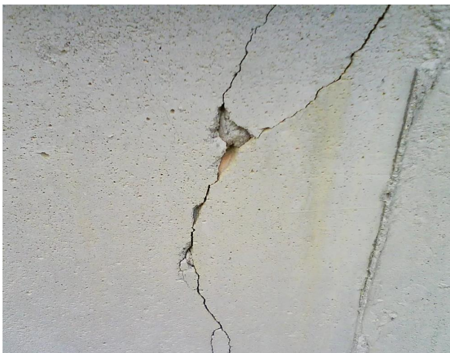
Рисунок 2 – Трещина в стене, возникшая из-за проникновения влаги
