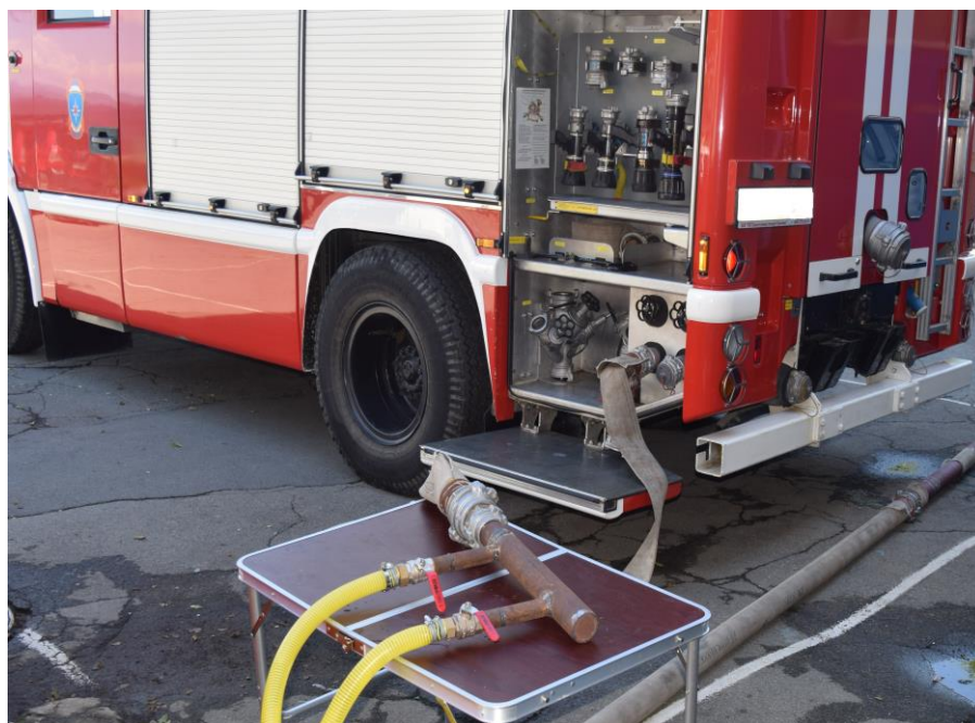
Рисунок 2 – Распределительное устройство, подключенное к пожарному насосу
