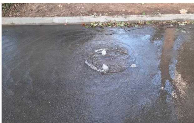
Рисунок 2 - Фотофиксация утечки при открытом пожарном гидранте на водопроводной сети
