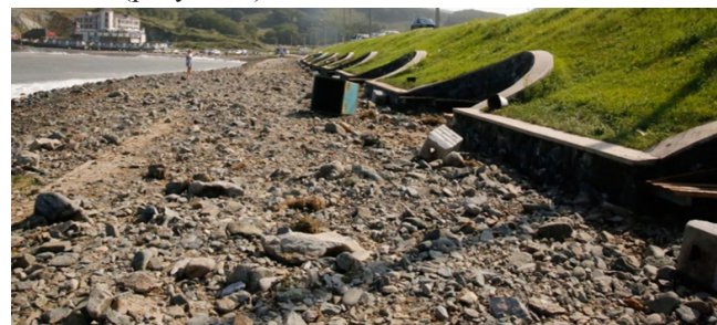
Рисунок 1 – Разрушенная городская набережная Рица после тайфуна «Майсак» (сентябрь 2020 г.)
