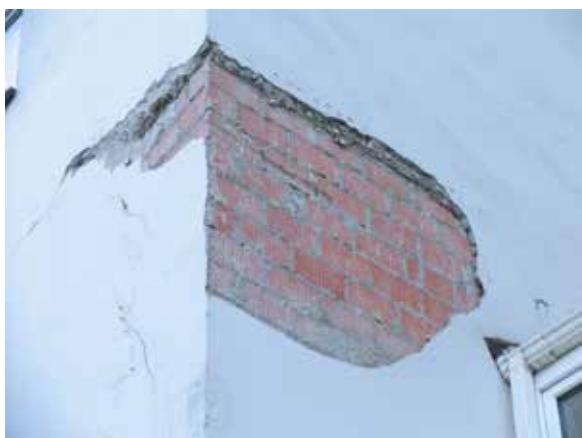
Рисунок 5. Разрушение наружного штукатурного слоя, выполненного по кирпичной кладке
