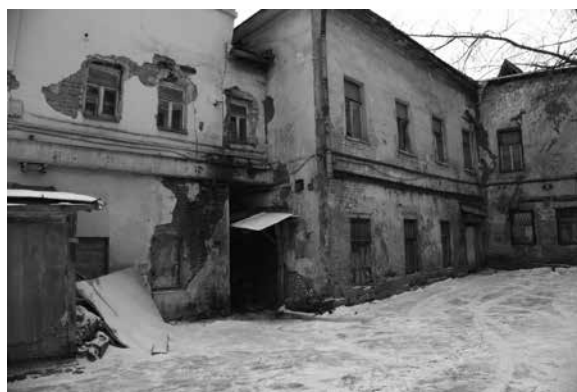
Рисунок 1. 1-я очередь реставрации. Руинированное состояние здания до реставрации и виброзащиты
