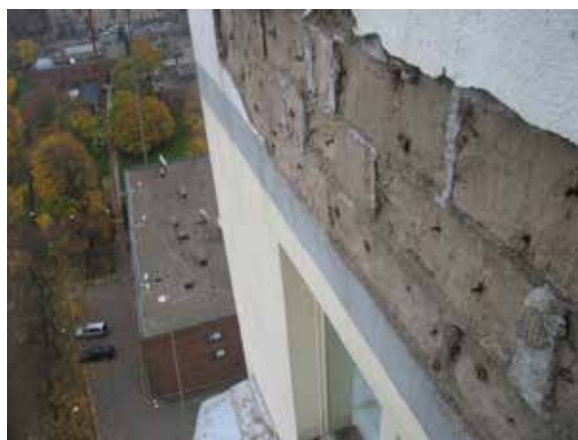
Рисунок 4. Разрушение наружного штукатурного слоя, выполненного по кладке, и ячеистых блоков
