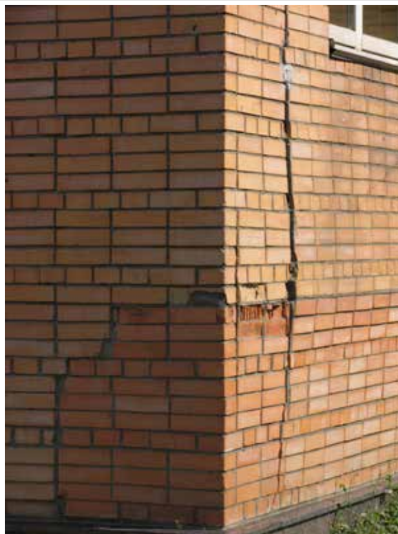
Рисунок 2. Вертикальная трещина наружной кирпичной кладки вдоль внешнего угла здания на 1-м этаже жилого дома
