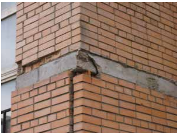
Рисунок 1. Жилой дом. Разрушение наружной кирпичной кладки в зоне монолитной межэтажной плиты перекрытия
