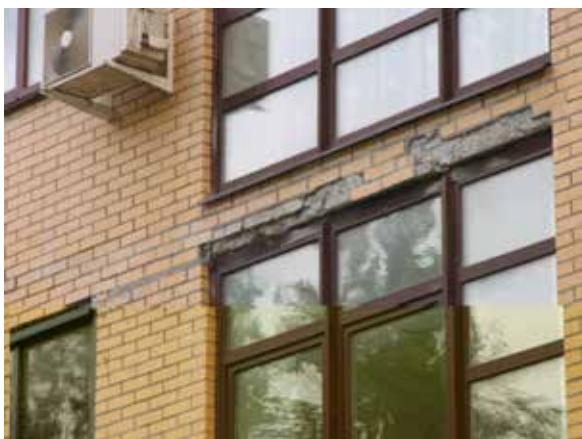
Рисунок 3. Жилой дом. Разрушение наружной кирпичной кладки вокруг оконного проема
