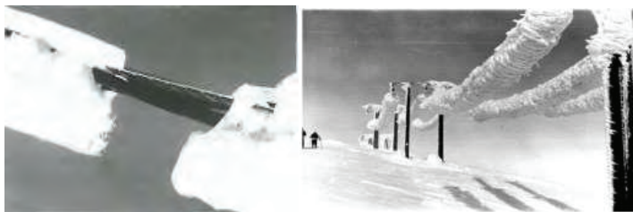
Рис. 2. Гололедные отложения на поверхности защищенных проводов
