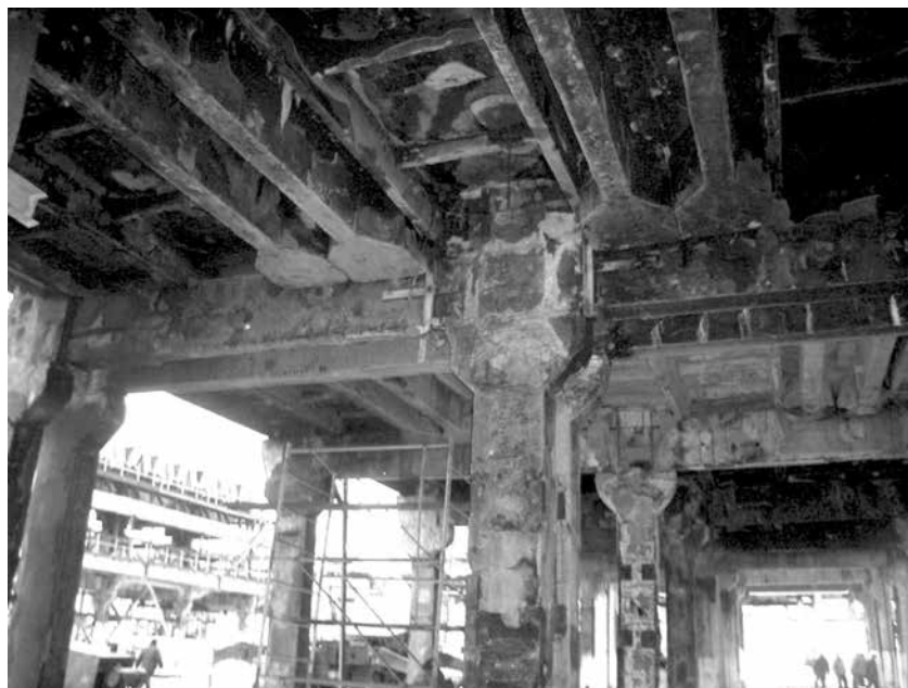
Рисунок 3. Состояние конструкций после пожара
