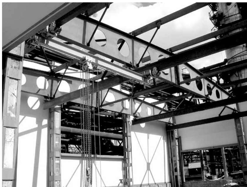
Рисунок 2. Установка новых металлических балок пролетом 18 м, усиление колонн обоймами и установка трехслойных панелей
