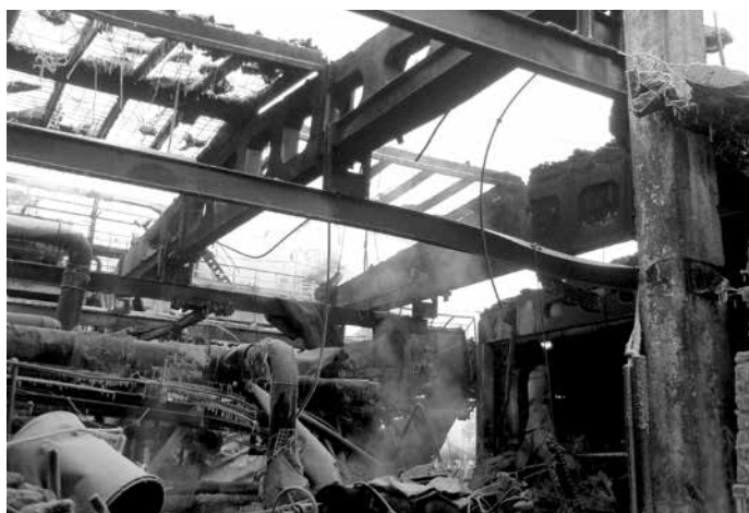
Рисунок 1. Разрушение здания после взрыва и пожара
